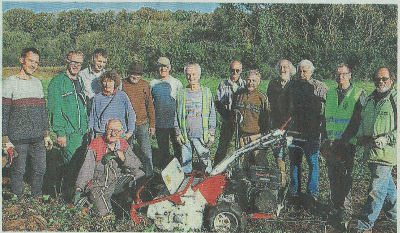
Une partie des membres du collectif porteur du projet voie verte Trans'Cornouaille sur le chantier de Pont-Denved, dont Éric Brouwer et le président de l'Association du patrimoine de Plovan, Pierre Gouletquer.
